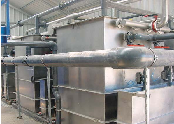
Anlage für 4000 EW, Recycling von kommunalem Abwasser
